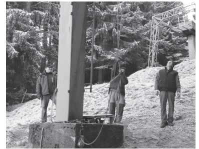
Lift Rollenbatterie Seilzug
