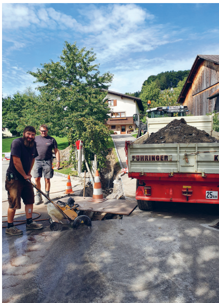
Wasserverlust machte Reparaturarbeiten am Fernwärmenetz erforderlich.
